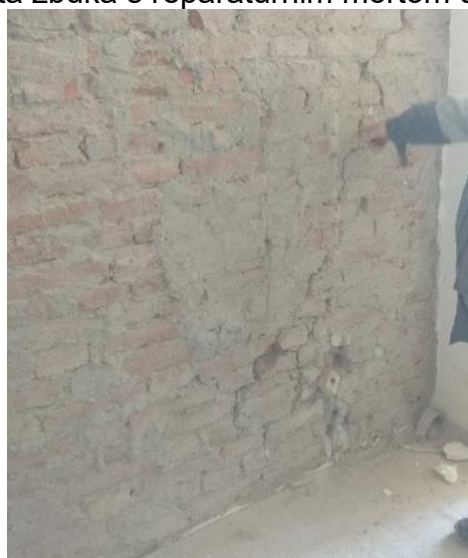
Pukotine širine veće od 10 mm
